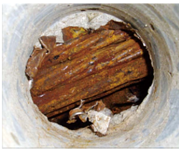
図3 グラウト充填不良の例 4)
