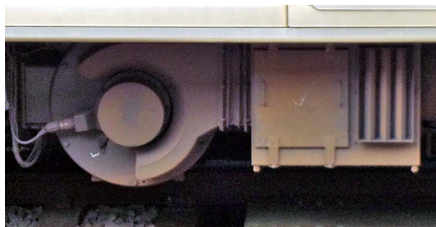
(b) 電動発電機
