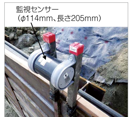
図2 監視センサーの設置例 （坂田電機提供写真）
