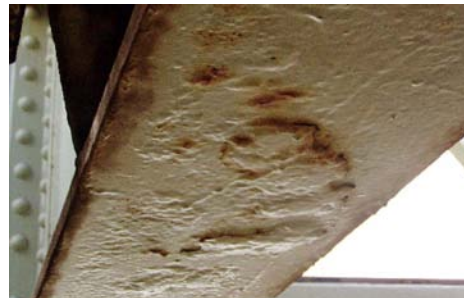
図 塗膜下での腐食が進行した例
