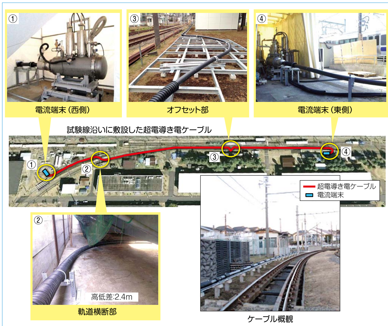
図4 敷設した300m級超電導き電ケーブル
