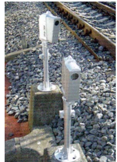
図7 踏切障害物検知装置の例 4)
