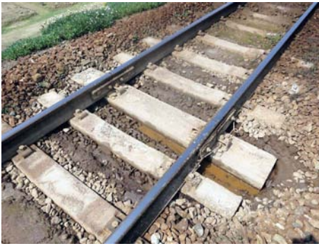
図1 噴泥の生じたバラスト軌道の例
