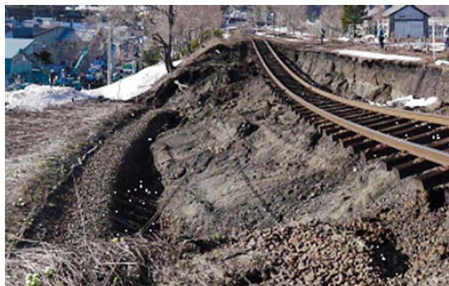
図 融雪期における盛土崩壊の例
