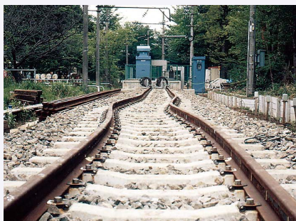
図1 軌道座屈の例(試験軌道)
