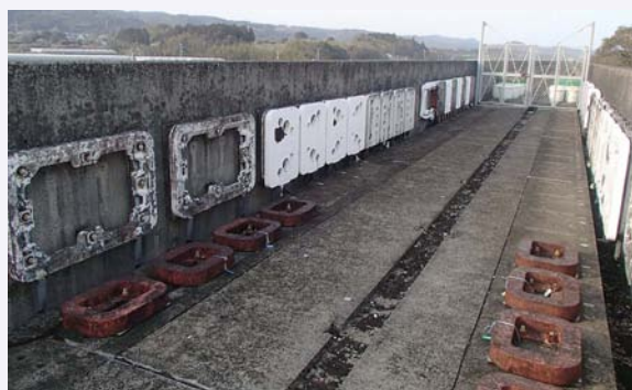
図 12 宮崎実験線に存置されている地上コイル (2016年3月撮影)
