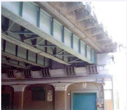
図7 東北本線柳原通り架道橋(合成桁) 出典：語り継ぐ鉄橋の技術，鹿島出版会発行，2008
