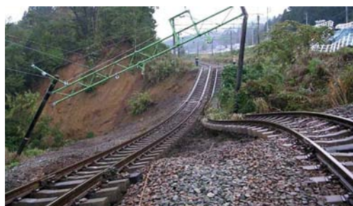
図1 地震による盛土の被災 1)
