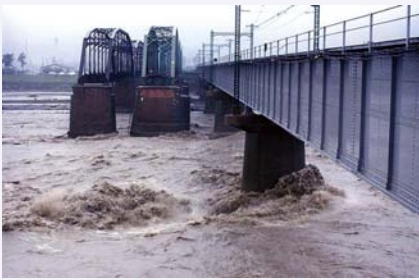
図8 富士川橋りょうの被災状況
