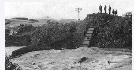
図6 第一富良野川橋りょうでの被災状況 出典：「国有鉄道線路災害記録 6) 」日本国有鉄道施設局
