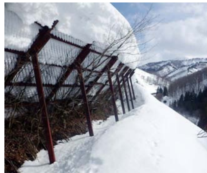
図1 雪崩対策工の一例(雪崩止め柵)
