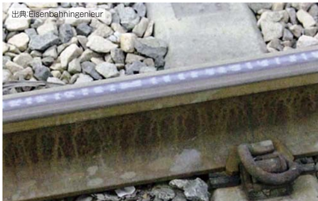
出典:Eisenbahningenieur レールの波状摩耗
