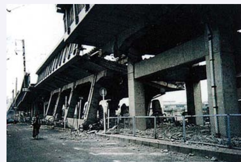
図3 兵庫県南部地震での高架橋の被災事例
