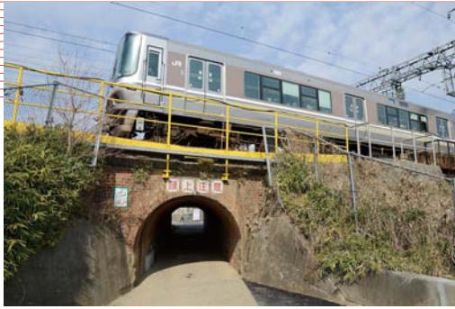
③明治時代初期の煉瓦造のアーチ橋（東海道本線 島本～高槻・奥田端橋梁／1876）
