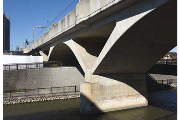
⑱アーチ構造を用いた越谷橋梁 (武蔵野線南越谷～越谷レイクタウン／2003)
