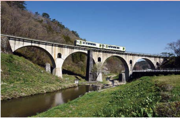
⑬鉄筋コンクリートアーチによる宮守川橋梁 (釜石線宮守～柏木平／1940)
