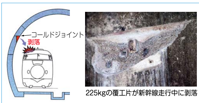
図3 1999年コンクリート剥落事故の例 2)
