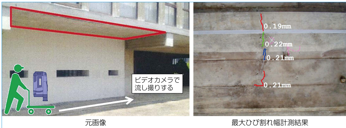
図2 張り出しスラブのひび割れ検出結果
