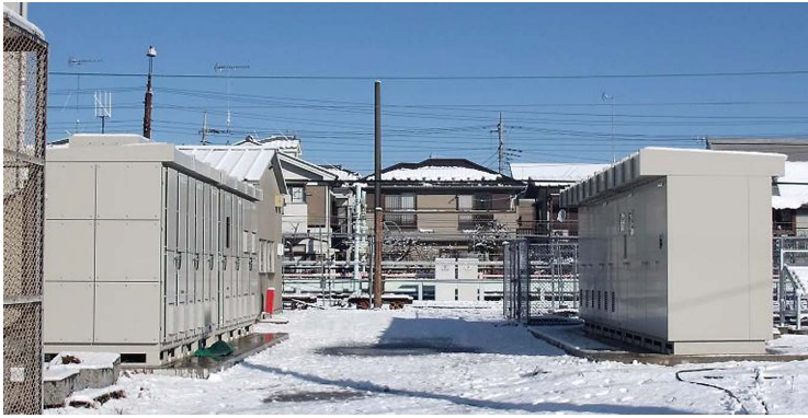
図3 鉄道総研の地上蓄電装置
