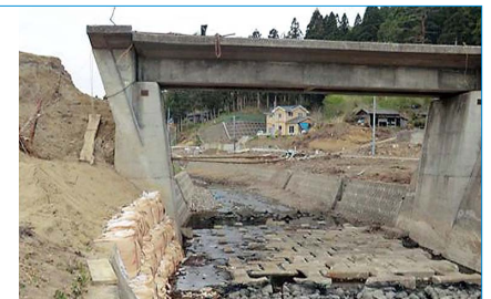
(b) 橋りょうと盛土の接続部における盛土の流出
