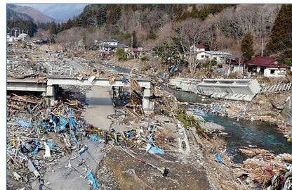
(a) 橋りょうにおける桁の流出
