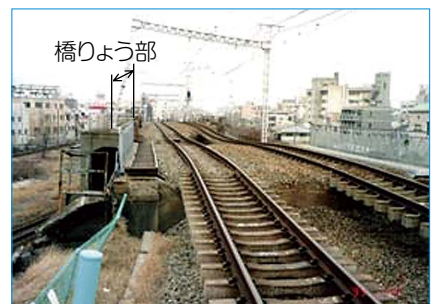
図2 兵庫県南部地震での橋りょうと盛土の境界部での被害 1)
