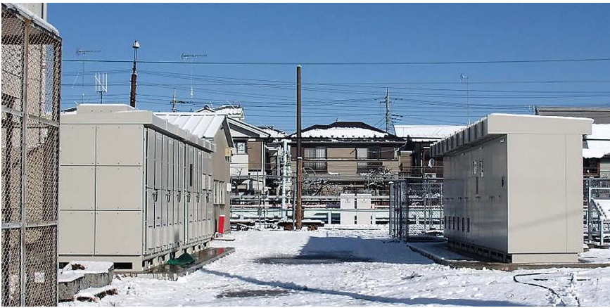
図6 地上の蓄電設備
