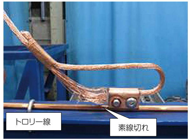
図3 コネクターリード線素線切れの例
