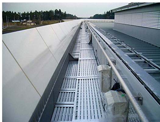
図2 融雪装置の設置状況
