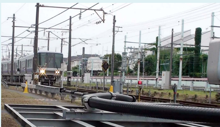
超電導き電ケーブルから電力を供給されて走行する試験電車（手前の黒い管が超電導き電ケーブル）
