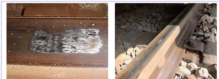
図3 空転により生じたレール損傷例
