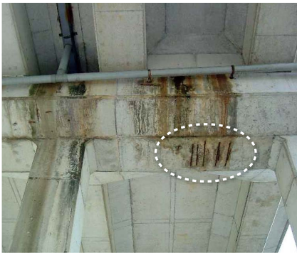
図1 水のかかる箇所での鉄筋露出
