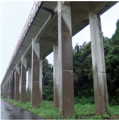
図3 コンクリート構造物への水がかり
