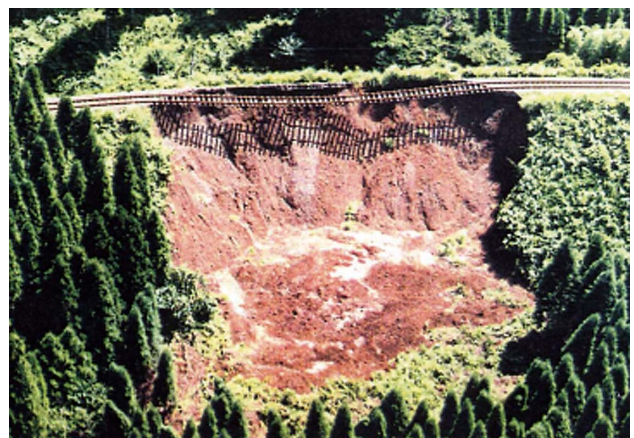
図1 降雨により盛土が崩壊した事例
