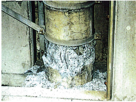
図1 電柱の根元の損傷
