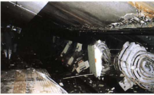
図2 兵庫県南部地震における大開駅の被害状況 2)
