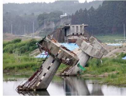
図11 橋脚の傾斜(気仙沼線)
