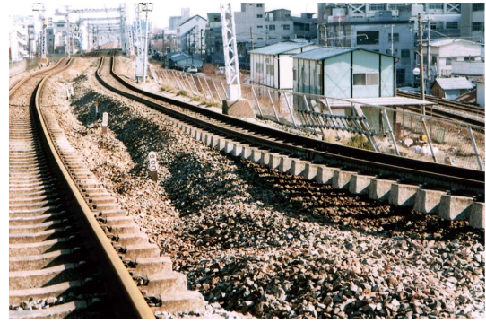
図3 兵庫県南部地震の盛土崩壊(1995年, 東海道本線)
