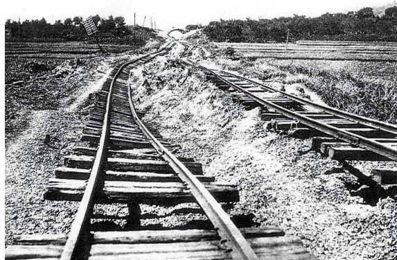
図1 関東大震災の盛土崩壊(1923年、東海道本線 現御殿場線)
