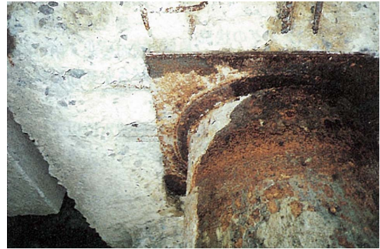
図5 兵庫県南部地震の杭頭のずれ(1995年, 建築基礎)
