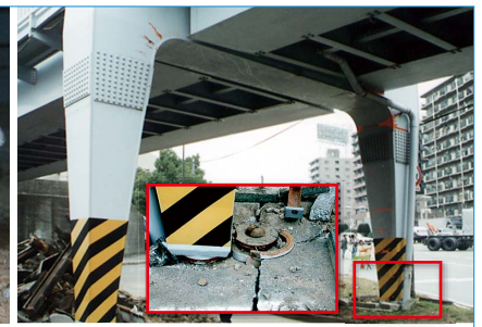
(b) ラーメン橋脚のピボット支承の逸脱
