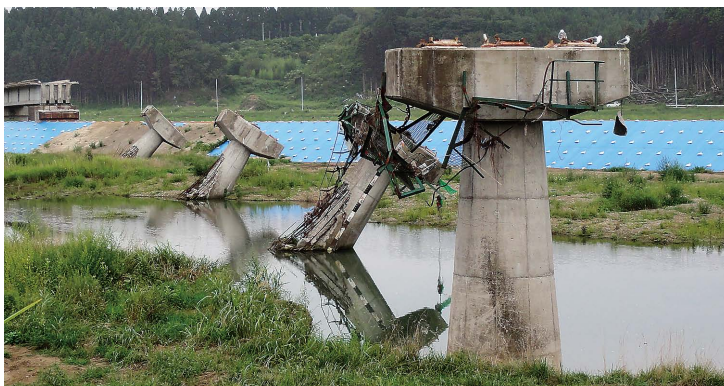
図12 津波による鉄道橋りょうの被害事例
