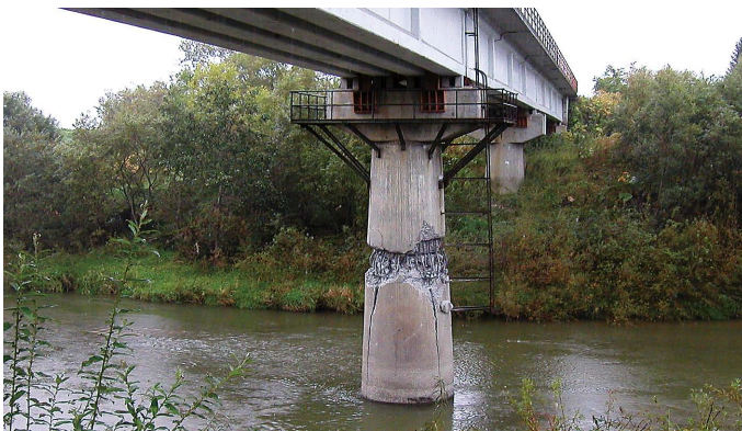
図5 RC橋脚の段落し部の地震被害事例
