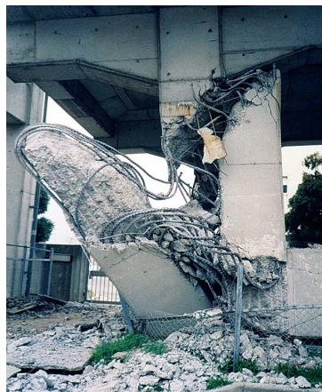
図3 柱のせん断破壊の例
