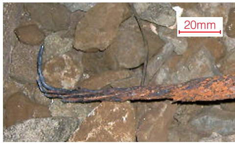
図2 全面腐食の例
