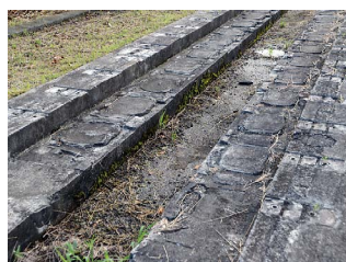
⑧かつて浮上用コイルなどが敷設されていた痕跡
