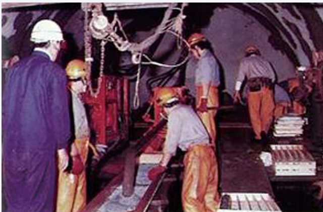
図5 青函トンネル坑内での先進ボーリング作業 出典:青函トンネル貫通, 応用地質, Vol.29, No.2, 1988.6
