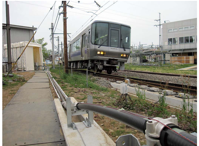
図8 鉄道総研実験線に敷設した超電導ケーブル
