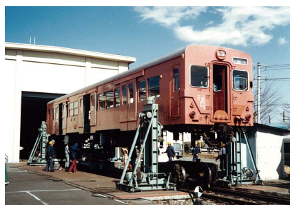
② 車体昇降装置を用いたキハ30-15号車の改造工事（昭和62年）
