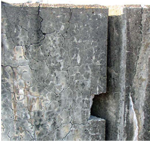
図1 ASRによるコンクリートの劣化事例
