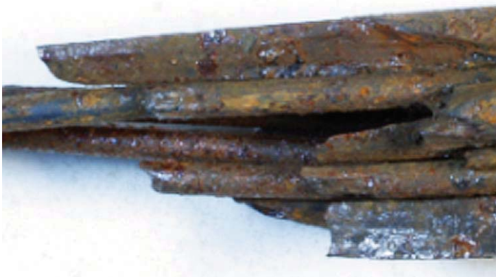
図3 腐食して破断したPC鋼材
