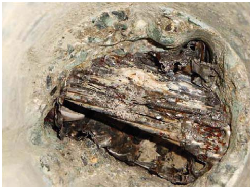
図2 グラウト充てん不良
