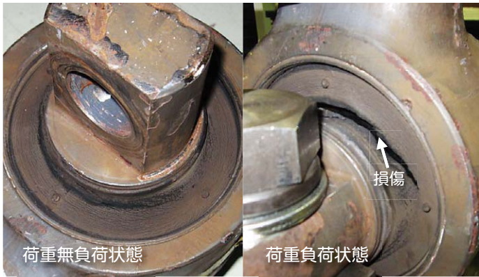
図2 一本リンクのゴムの損傷
