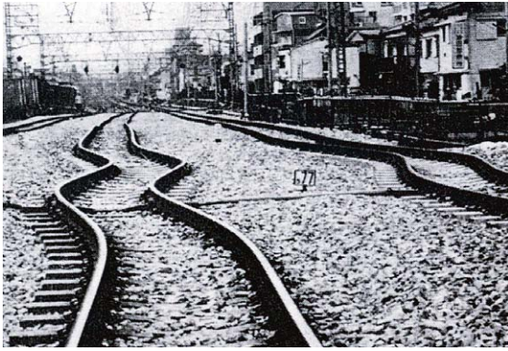
図1 地震を受けた軌道の変状の例
