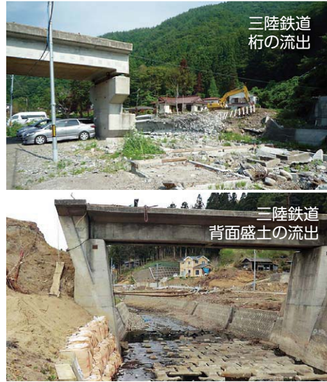
図5 従来形式の橋梁における津波被害の例
