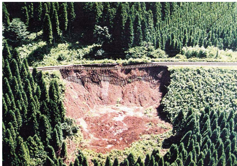
図1 降雨により盛土が崩壊した事例
