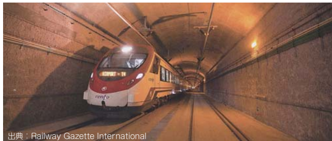
空港線の新トンネル内の剛体架線は3kVDCと25kVAC50Hzの両方でき電できるように設計されている。
