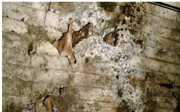
図2 トンネル壁面の劣化
