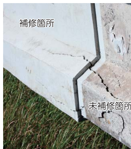
図1 部分断面補修箇所周辺の再劣化
