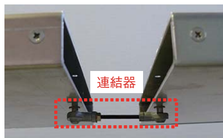
図7 連結器部分の外観(連結器取り付け位置④の場合)
