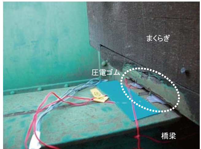
図9 圧電ゴムの設置状況
