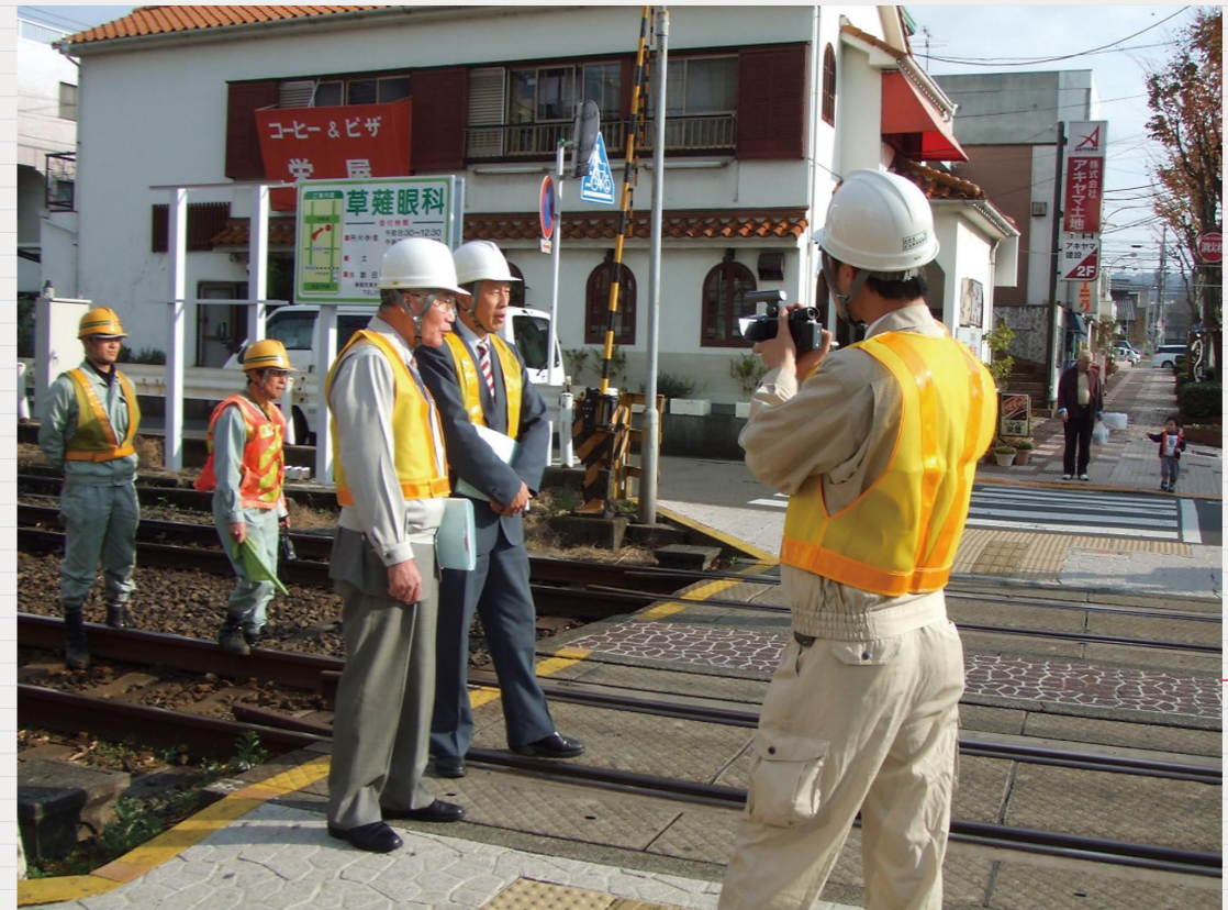
【訪問アドバイス】 踏切保安設備の更新について、レールアドバイザーより技術的なアドバイスをしています。
